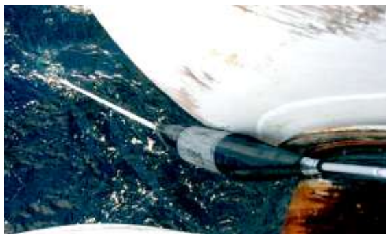
センサーケーブル設置
